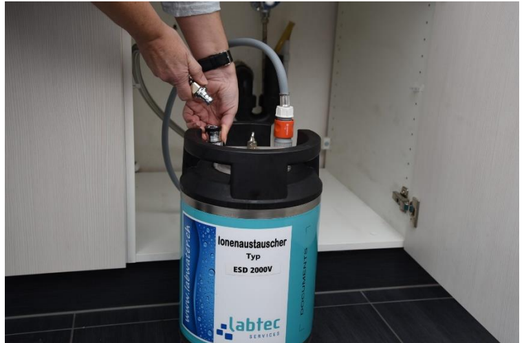
Regeneration Ionenaustauscher, Kantonspolizei Fribourg
